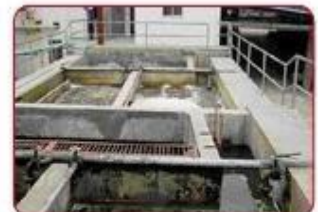
污水池水位测量
